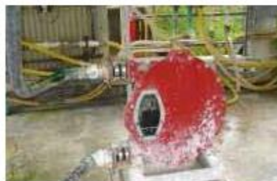
شکل یک: پمپاژ لجن
